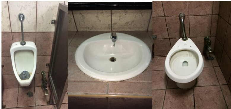
Figura 1. Mobiliario sanitario de la Facultad de Ingeniería Civil.
